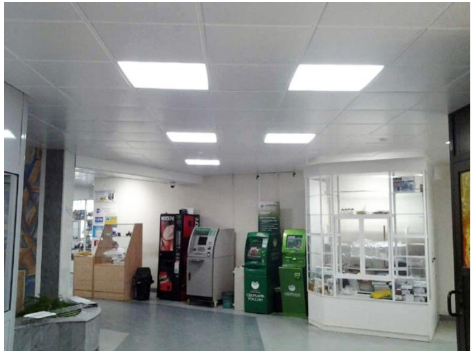
Рис.13 Светильник для помещений с потолком типа «Армстронг» со световым потоком 3500 Лм при мощности 35 Вт.
